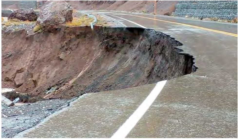
Dos grandes socavones del lado argentino "se comieron la ruta", descalzando el camino y haciendo intransitables algunos tramos de la RN 145.
