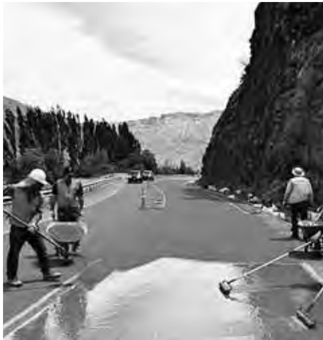
Profesionales, técnicos y operarios chilenos trabajaron en la aplicación de los sellos de alta fricción en los kilómetros 86, 87 (Curillínque) y 129 (Vacas Muertas), sectores que en condiciones extremas presentan formación de hielo en la calzada.
